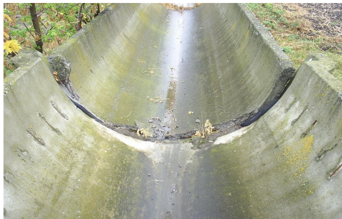
Рисунок 2 – Смещение лотков на стыках соединений лоткового канала Азовской оросительной системы
