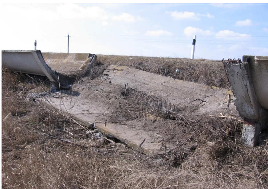
Рисунок 1 – Полное разрушение лотка Кубань-Калаусской оросительно-обводнительной системы
