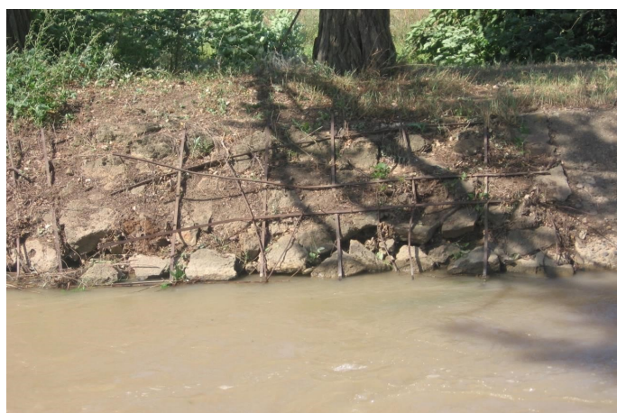
Рисунок 3 – Полное разрушение железобетонных элементов облицовки и грунтового основания Дундинского распределителя Право – Егорлыкского магистрального канала
