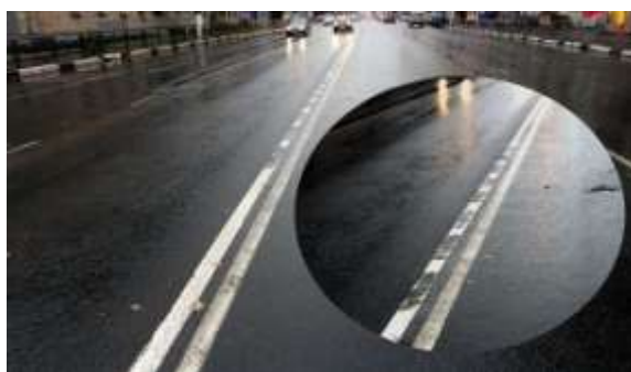
Рисунок 3 – Отслоение дорожной разметки
