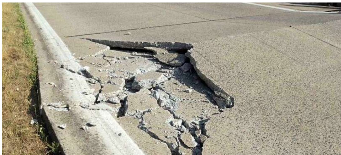
Рисунок 4 – Разрушение цементобетонного покрытия
